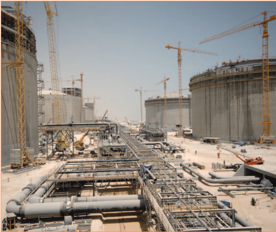
LNG tank farm
